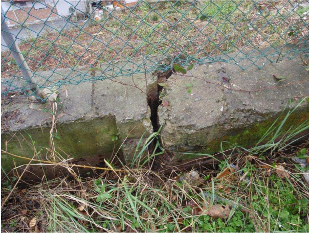
[Fig. 1].- Rotura del muro en su tramo central
