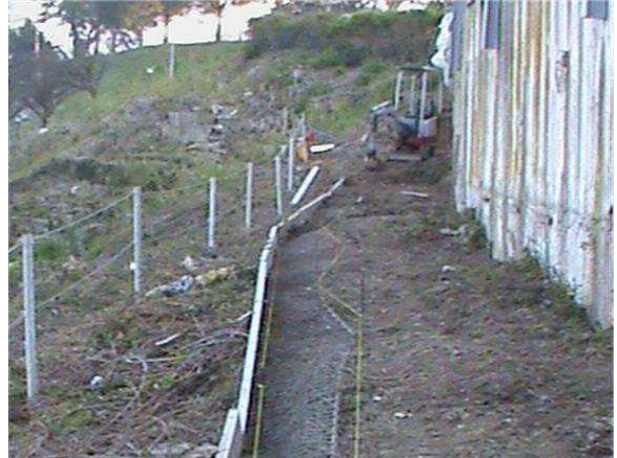
[Fig. 3].- senos de tension en el cable de cabeza de la malla tecco. Indican desplazamiento de masa delante de el. Tel talud empuja y la malla tira del cable, estos senos se dan en unos 15 metros entre 5 anclajes de cable
