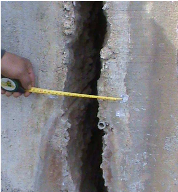
[Fig. 4].- Grieta entre tramos de muro. Presenta apertura decimétrica y desarrollo métrico. No hay armadura de continuidad, ni en muro ni en zapata. El empuje de tierras rompe la junta y desploma el muro
