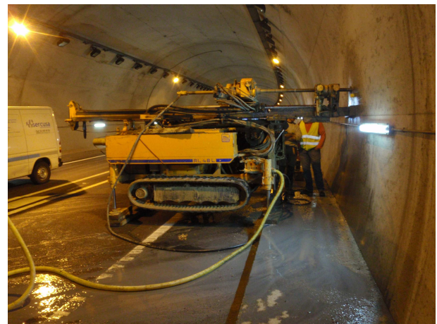
[Fig. 3].- Sondeos con recuperación de testigo efectuados en el material de revestimiento hasta el contacto con la roca.
